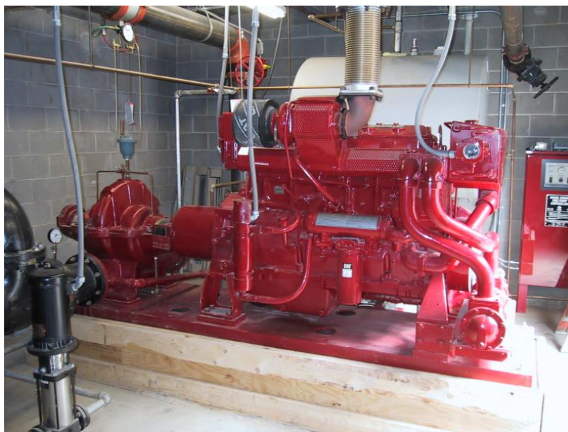
Gambar 6.3.5.2 – Pompa Kebakaran digerakkan dengan Diesel
