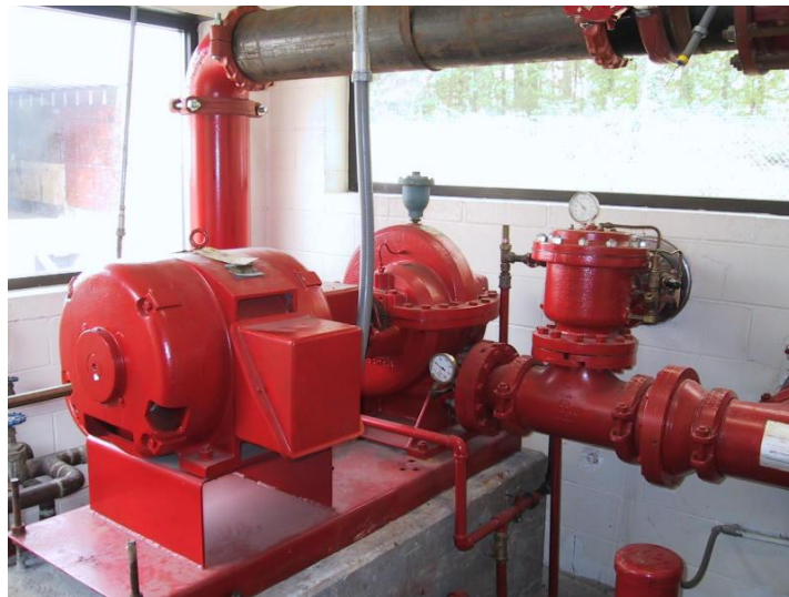
Gambar 6.3.5.1 – Pompa kebakaran digerakkan dengan listrik
