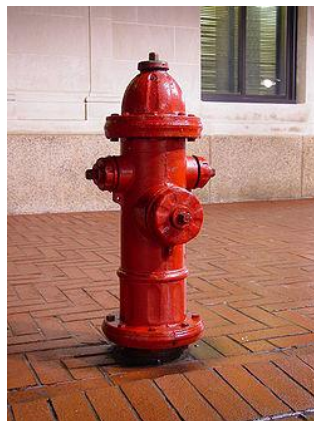
Gambar 4.8 3 - Hidran halaman dengan 2 outlet \varnothing 2\frac{1}{2} ", mampu memasok air 2 x 250 gpm
